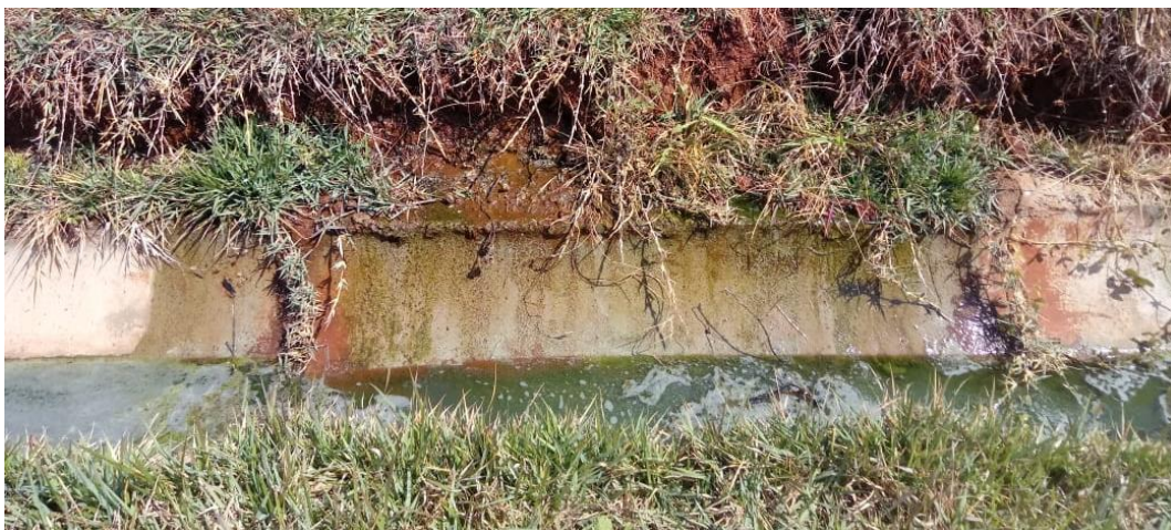
Figura 14. Afloramento de chorume percolado nos taludes da lagoa facultativa 1.
