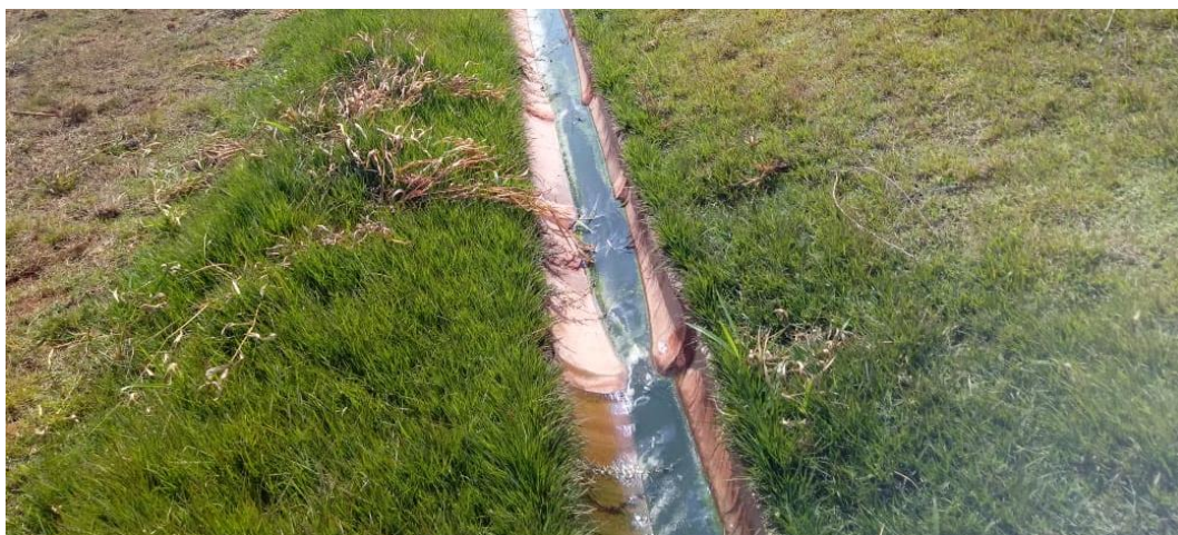
Figura 13. Afloramento de chorume percolado nos taludes da lagoa facultativa 1.
