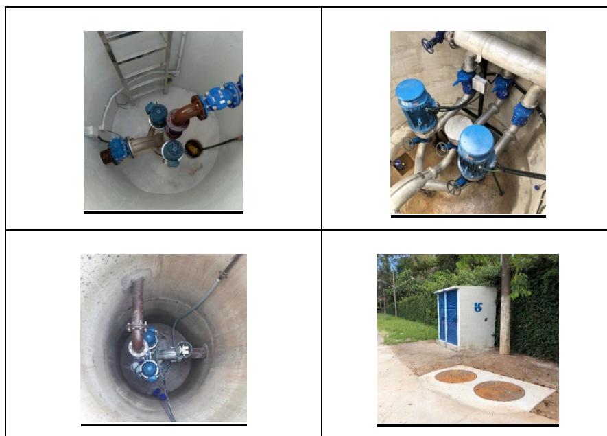
FOTOS DE INSTALAÇÕES REALIZADAS
