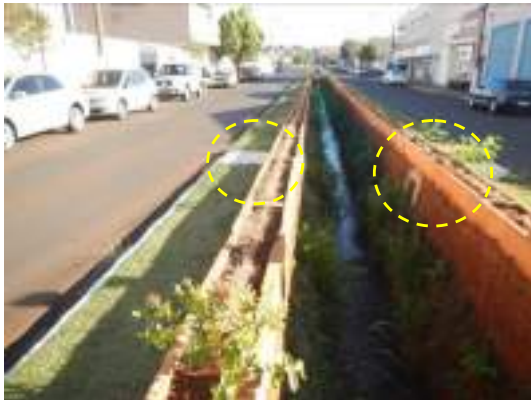
Figura 26 – Córrego da Água Vermelha, retificado, com as bocas de lobo recém implantadas pela prefeitura.
