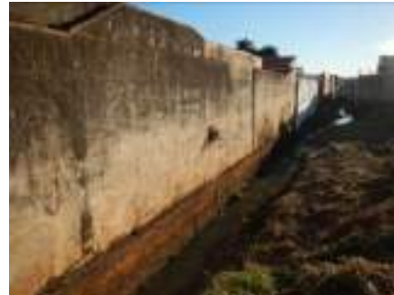
Figura 16 – Moradias sem recuo para a drenagem.
