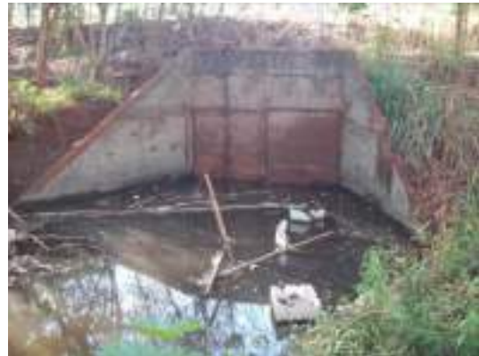
Figura 27 – Comporta de controle de cheias do Córrego Água Vermelha, acumulando detritos e lixo. Situa-se a montante da incurção do rio na cidade.
