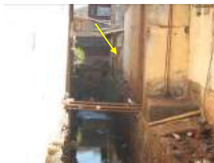
Figura 14 – Edificação próxima à margem do Córrego do Norte, com fissuras (destaque).
